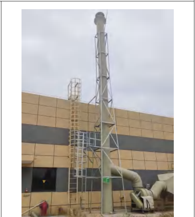
危废仓库废气处理装置的出口
