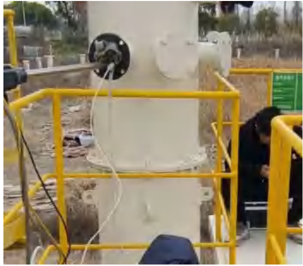
碱喷淋+RTO 装置废气排放口
