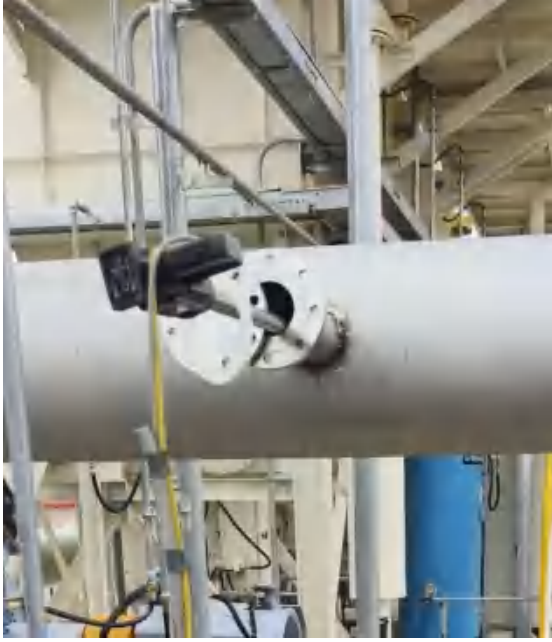
碱喷淋+RTO 装置废气进口
