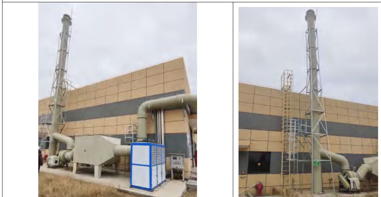
危废仓库活性炭吸附装置及其废气排放烟囱
