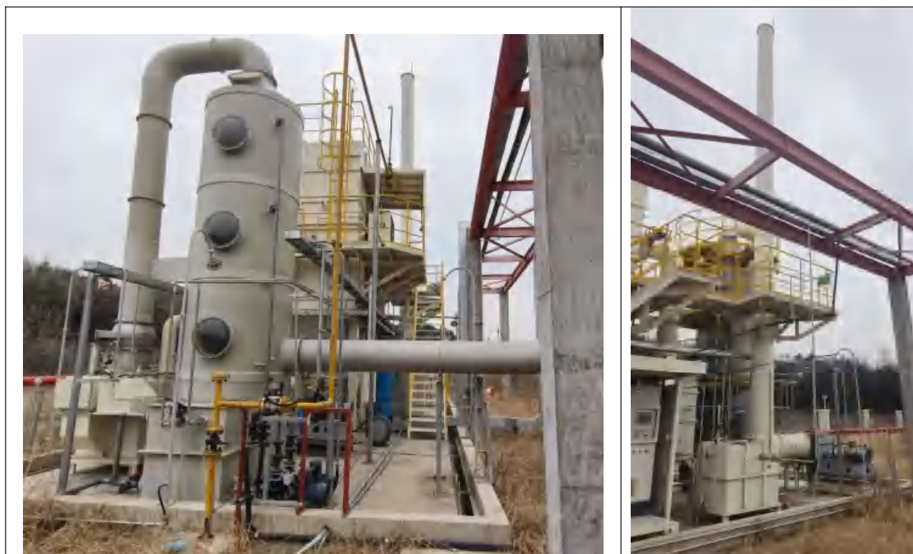
冷凝+碱喷淋+RTO 及其废气排放烟囱
